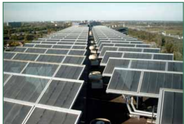
Fotovoltaïsche panelen Bron: IZEN
