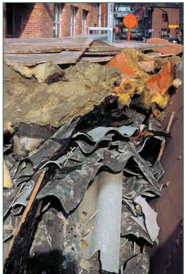
Golfplaten van asbestcement zijn terug te vinden op vele tuinhuisjes. Bron: VIBE
